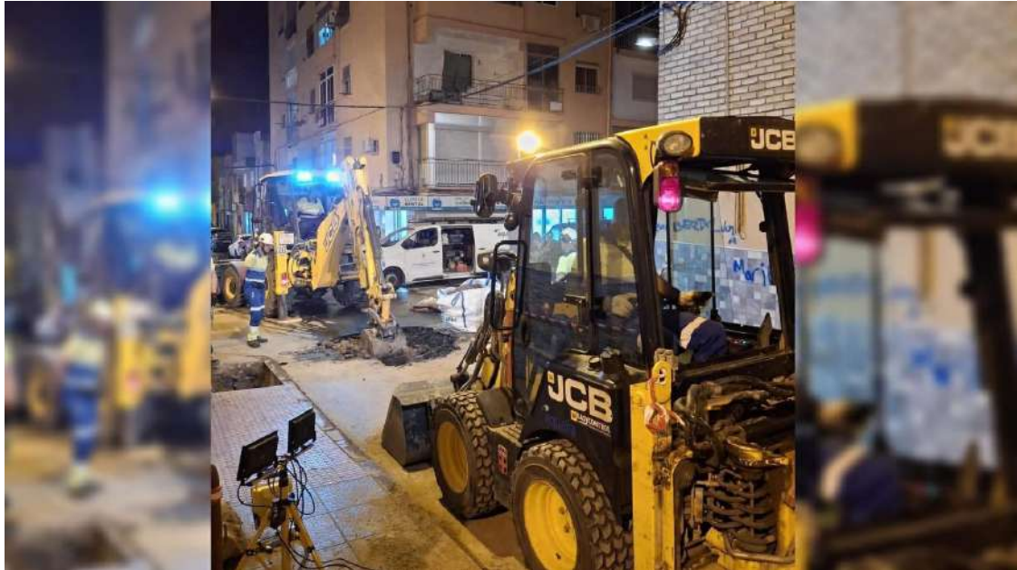
Trabajo a contrarreloj para recuperar la normalidad en el barrio de Los Ángeles de Almería.
